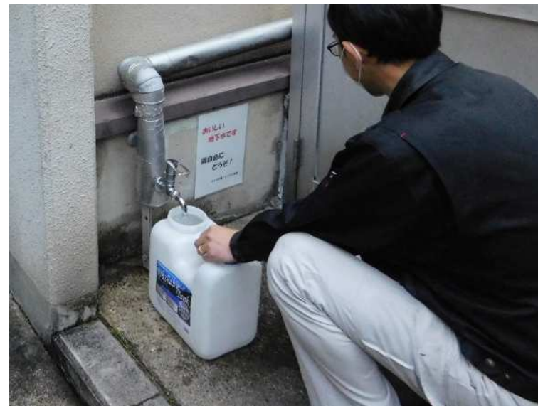
敷地内の水栓
